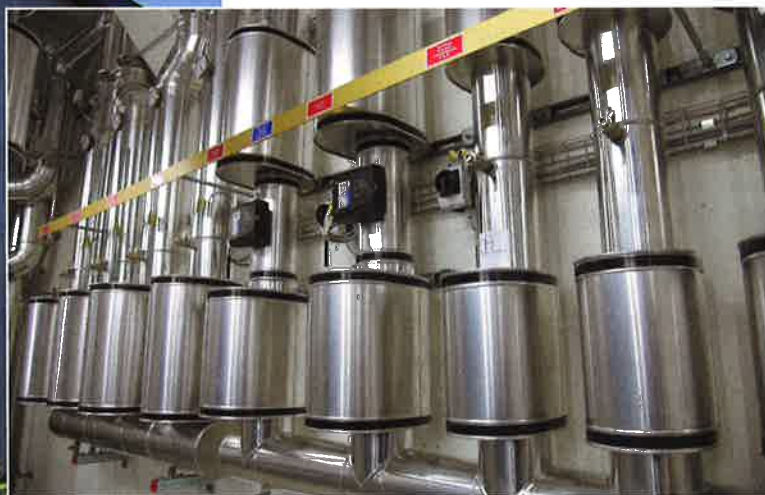
Ab den Energiezentralen des schrittweise auszubauenden Anergienetzes werden die einzelnen Gebäude der FGZ mit Wärme versorgt.
