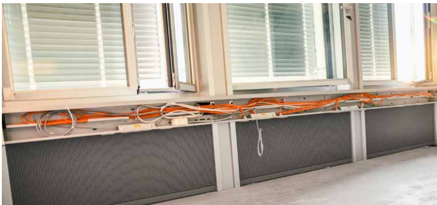
Die Kabel sind nun durch Kanäle unterhalb der Fenster geführt. Entfernt wurden die eingehängten Decken, während die Flächen in den Radiatorennischen mit schalldämmenden Platten versehen sind. Die Massnahmen erhöhen die Wärmespeicherkapazität der Betondecke, was insgesamt die Kühlwirkung verbessert.
