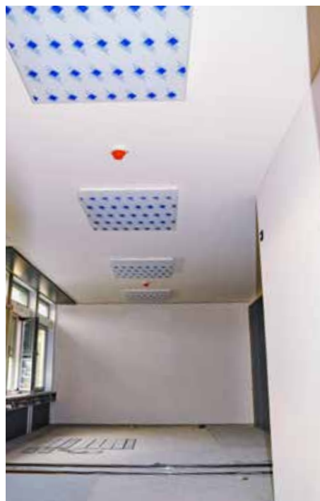
Eine Massnahme zum verbesserten indirekten Wärmeschutz: In den Räumen erhöhen die freigespielten Decken die Wärmespeicherfähigkeit gemäss SIA-Norm 180 auf «mittel».
