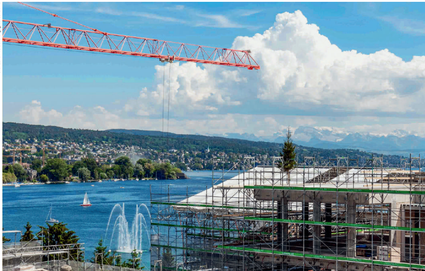
Blick auf die Alpen, die Goldküste, den Zürichsee samt Fontäne und das Tannenbäumchen vom Aufrichte-Fest: Der Hauptsitz der Zürich Versicherungsgesellschaft AG am Mythenquai liegt ebenso verkehrsgünstig wie idyllisch und wird in Zukunft Arbeitsplätze von höchster Qualität bieten.
