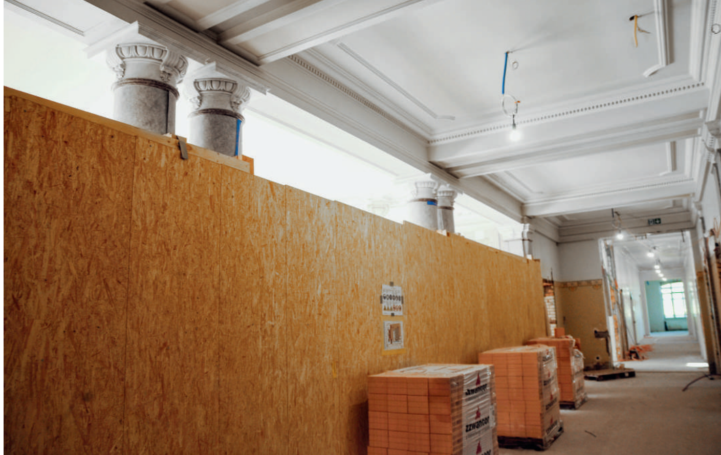
Blick in den Korridor des Verwaltungsgebäudes von 1901. Sowohl an der Gebäudehülle und der Umgebung als auch im Inneren galt es, die historische Bausubstanz sorgfältig zu sanieren und während der Umbauarbeiten vor Beschädigungen zu schützen.
