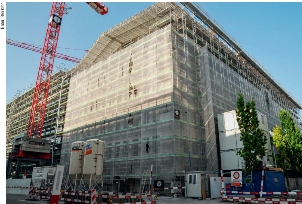
Die Rückseite der Baustelle an der Alfred-Escher-Strasse: Die Kombination aus Sanierung und Neubau, noch dazu mit den Erfordernissen von drei unterschiedlichen Nachhaltigkeits-Labels, erfordert ein Höchstmass an umsichtiger Planung, ständiger Qualitätskontrolle und Sorgfalt bei der Ausführung.
