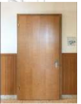
Brandschutz- türen (aus Schulhaus)
